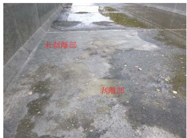
写真－1 底版表層剥離（踏査区間－1 SP3040付近）
