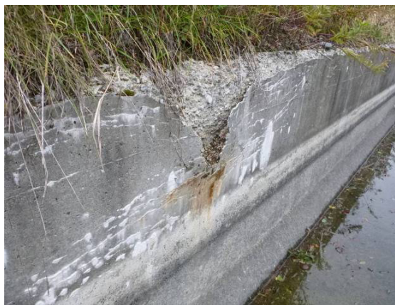
写真－3 側壁天端剥離（踏査区間No.2 SP6700付近）
