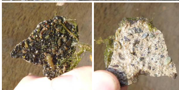
写真－4 剥離片の状況
