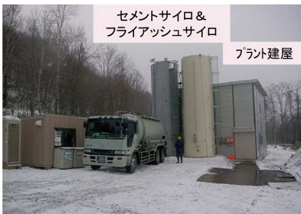
写真-4 プラント外観全景
