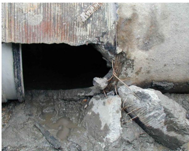
写真－6 PC管の破損箇所（他地区事例）
