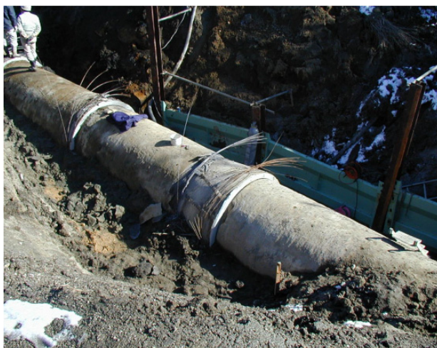
写真－5 PC鋼線の破断（他地区事例）
