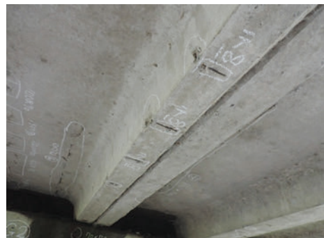
写真－2 剥離・鉄筋露出状況
