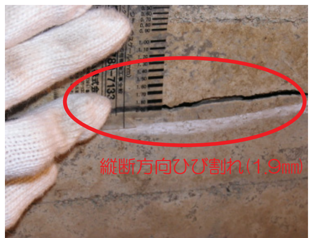
写真-2 縦断方向ひび割れ（SP. 1, 560付近）
