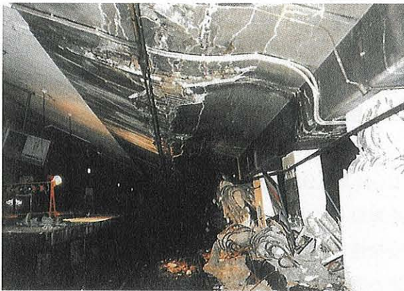
写真-7 神戸高速大開駅の中柱の破損 7)
