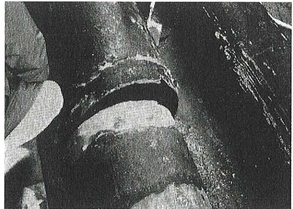
写真-6 鋼管パイプの抜け出し 6)
