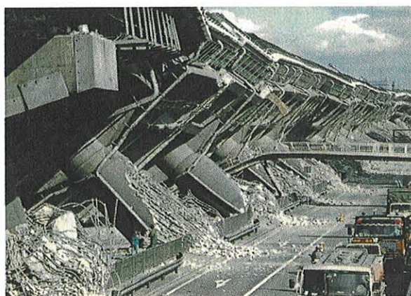
写真－3 高速道路(高架橋)の倒壊 3)
