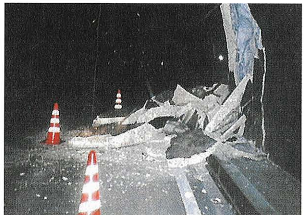
写真-8 万滝トンネルのライニング破損 8)
